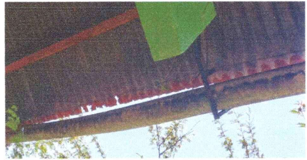
Foto 2: MÓDULO 1 EVIDENCIAS DEL DETERIORO DE LÁMINAS. ESTE PROBLEMA SUELE VERSE EN TODAS LAS ORILLAS DEL TECHO.
