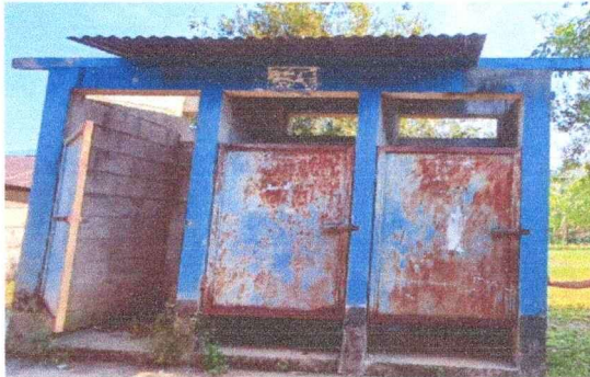
Foto 13. Módulo 3, Sustitución de techo, por motivo de deterioro y los fuertes vientos han hecho que en algunas partes no contara con techo.
