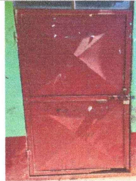
Foto 4: MÓDULO 1 Sustitución de Puerta de la Dirección, la puerta se encuentra con desperfectos, es difícil poder abrirla y cerrarla, como también en la parte inferior se ha desgastado por mucho tiempo de uso.
