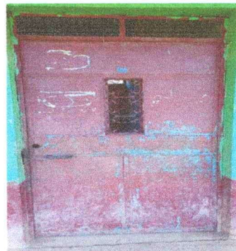
Foto 10. Módulo 2, Sustitución de puerta del aula de quinto Primaria, debido a que la cerradura está inservible y es insegura, la puerta también ya está deteriorada.
