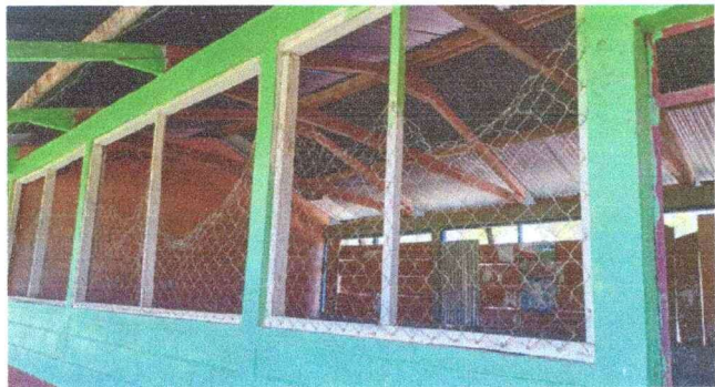
Foto 9: Módulo 2, Parte frontal del aula de Quinto primaria, donde se realizará la sustitución de ventanas, de ese lado se encuentra forrado con malla y ya se encuentra en mal estado.
