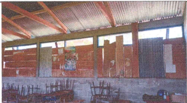
Foto 7, Módulo 2, Las ventanas de las aulas de Quinto Primaria del módulo 2, únicamente se encuentra forradas con madera y se encuentran en pésimas condiciones .
