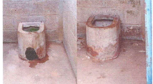
Foto 14. Módulo 3 Sustitución de tazas sanitarias, debido a que se encuentran en pésimas condiciones, con rajaduras, y piezas faltantes.
