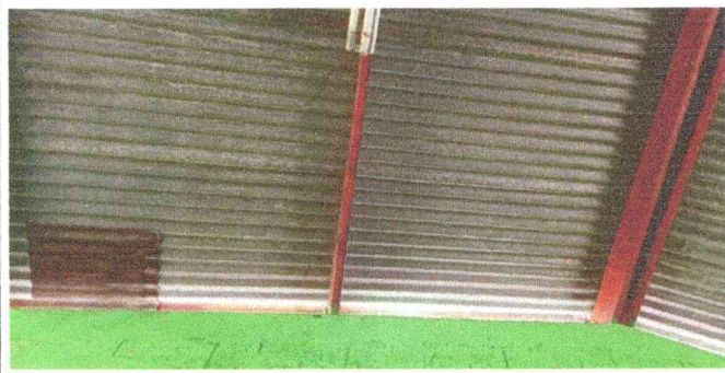
Foto 3: MÓDULO 1 INTERIOR DE LAS LÁMINAS. En la parte interior de las aulas se ve que el óxido ya paso, y los padres de familia no cuentan con recursos necesarios para una reparación.
